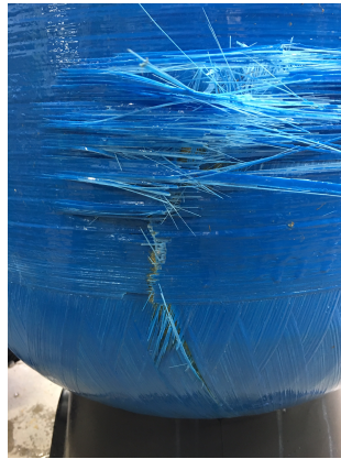
5. Tanque Colapsado - Fibra Totalmente Rota
