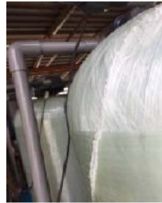
6. Daño Exterior en Fibra
