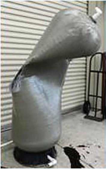
1. Tanque Totalmente Colapsado - Implosión
