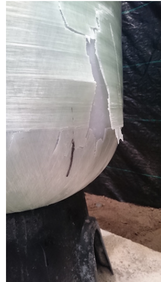
3. Tanque Parcialmente Colapsado
